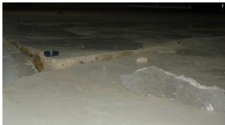
FIGURE N°21 : DALLAGE SOULEVE PAR LES EAUX SOUTERRAINES
