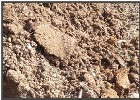
FIGURA n°25: PRESENCIA O NO DE LODO EN EL TERRAPLENADO
