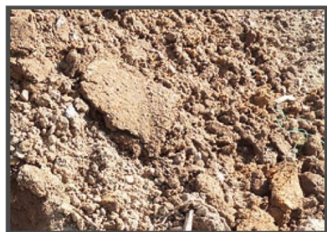
FIGURE N°25 : PRESENCE OU NON DE BOUE DANS LE REMBLAIS
